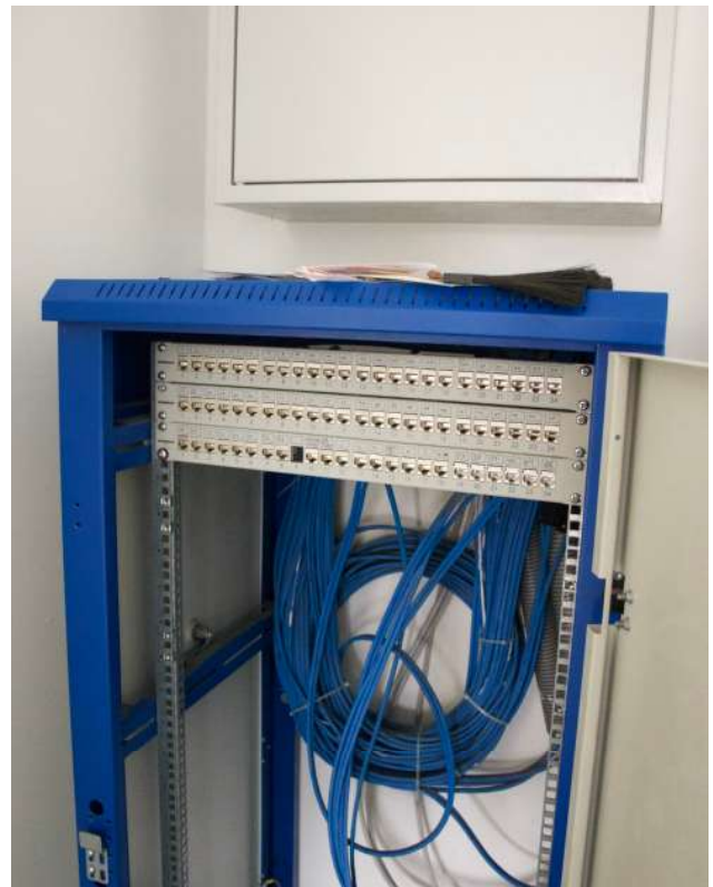
Serverschrank mit LAN-Anschlüsse
