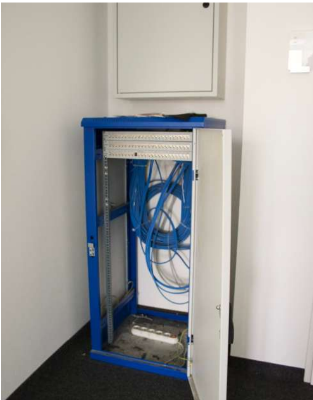
Serverschrank mit LAN-Anschlüsse
